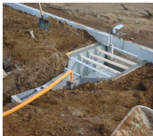
Photo 3.8-3 開水路の流量測定に用いられるパーシャルフリュームの設置例。（写真：㈱セネコム提供）
