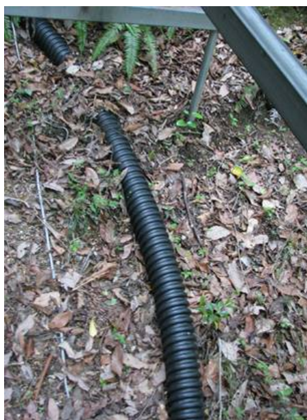
Photo 1.2-7 転がし配線。森林では林床の起伏があるので転がし配線の場合も地中埋設用の蛇腹保護管を用いた方が作業性が高い。（山城水文試験地）
