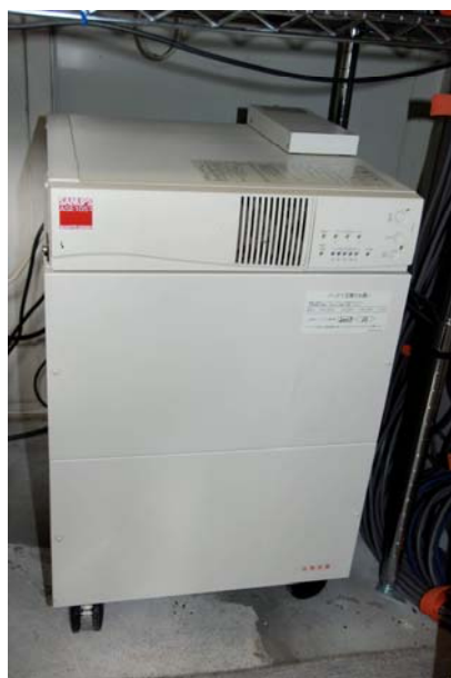
Photo 2.7-3 無停電電源装置。
