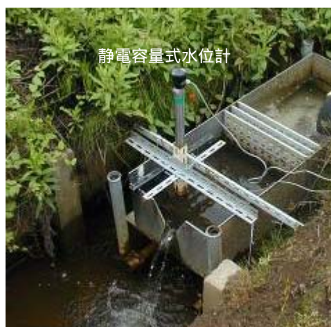
Photo 3.8-2 水槽型量水堰（三角堰）を用いた排水量の測定例。（真瀬水田フラックスサイト）
