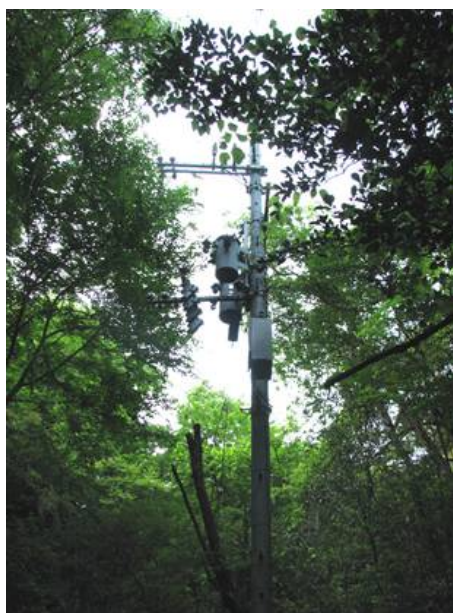
Photo 1.2-6 森林内での空中配線。 （山城水文試験地）
