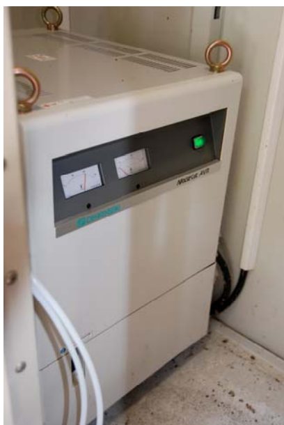
Photo 2.7-2 電源用ノイズカットトランス。
